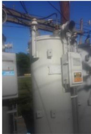
Subestacion reguladora. Transformador No 1.
