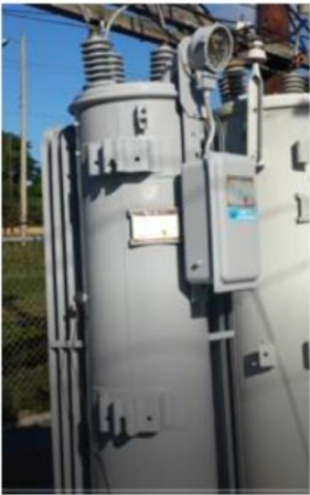
Subestacion reguladora. Transformador No 1.
