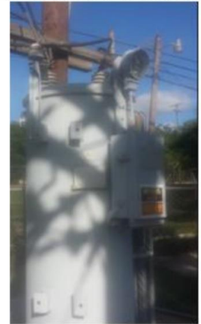
Subestacion reguladora. Transformador No 1.
